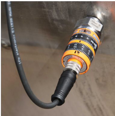
Sensor position on fan casing. (A2 : VKV 021)
